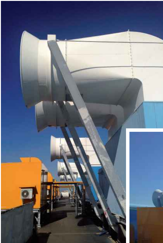
Travaux de rénovation des centrales de traitement d'air © Centre Pompidou / photo S. Dugauguez
